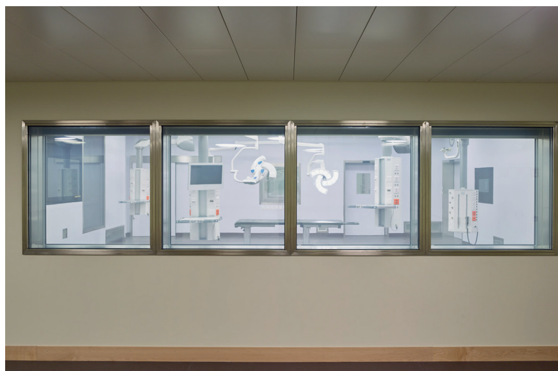
OP-Fenster vom Korridor aus mit elektrochromen Glas für Sichtschutz, Neubau SPZ
